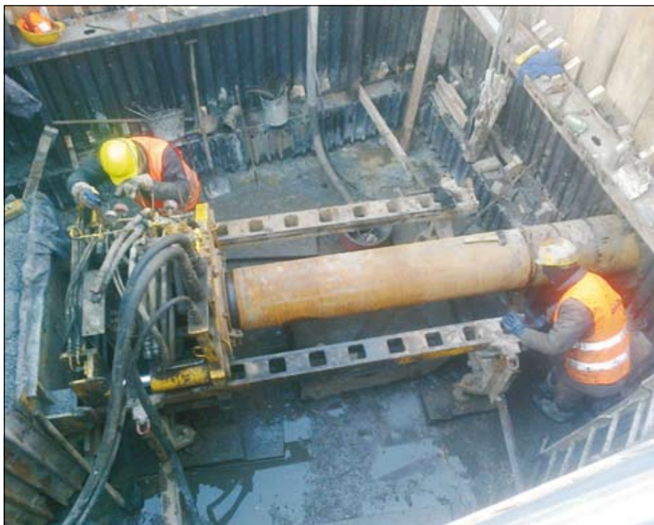
Foto startovací jámy bezvykopové technologie. Pracovníci za pomoci hydraulického zařízení provádějí průtlak pod komunikací.
