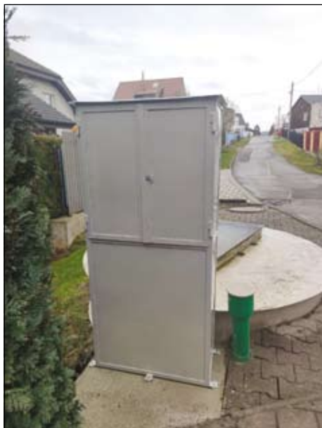
elektrický rozvaděč na přečerpávací stanici Finské domky
