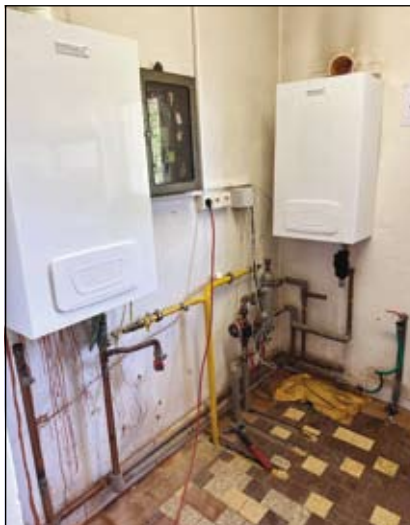
kotelna za podiím v sále Obecního domu s nově instalovanými kotli
