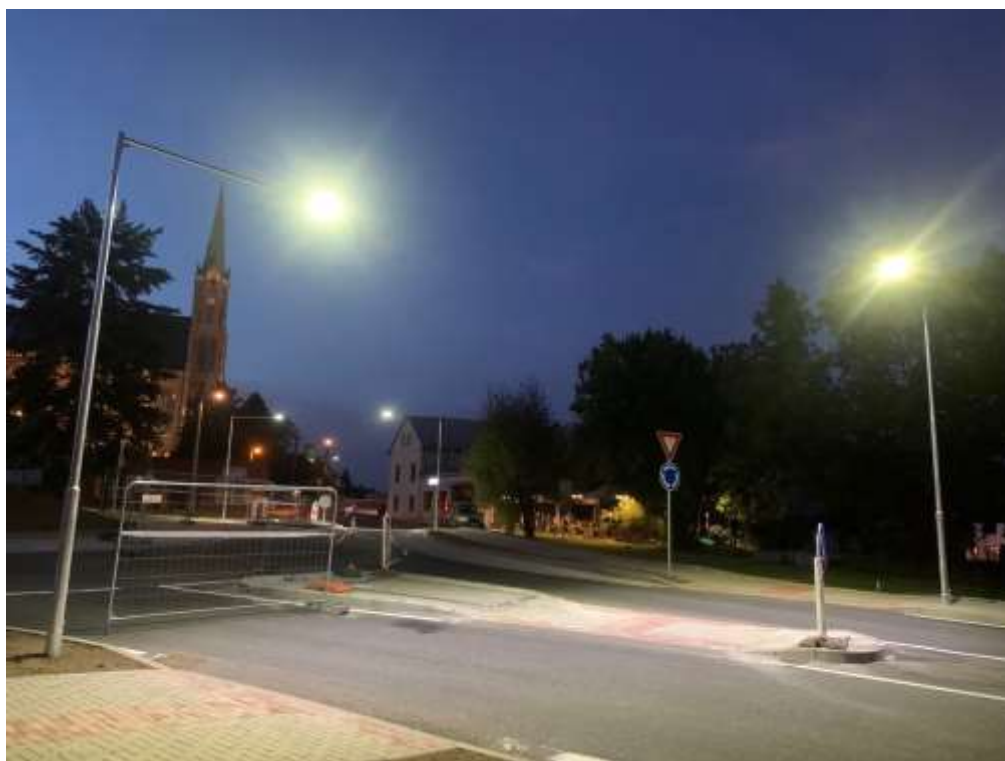
osvětlení kruhového objezdu – stav k 11. 10. 2023 – foto P.K.
